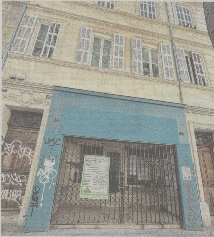
Le local du 94, boulevard de la Libération a été acheté en 2021 mais de lourds travaux restent à effectuer pour réhabiliter les lieux.
